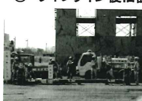
堺市上下水道局が下水管損傷の緊急措置
